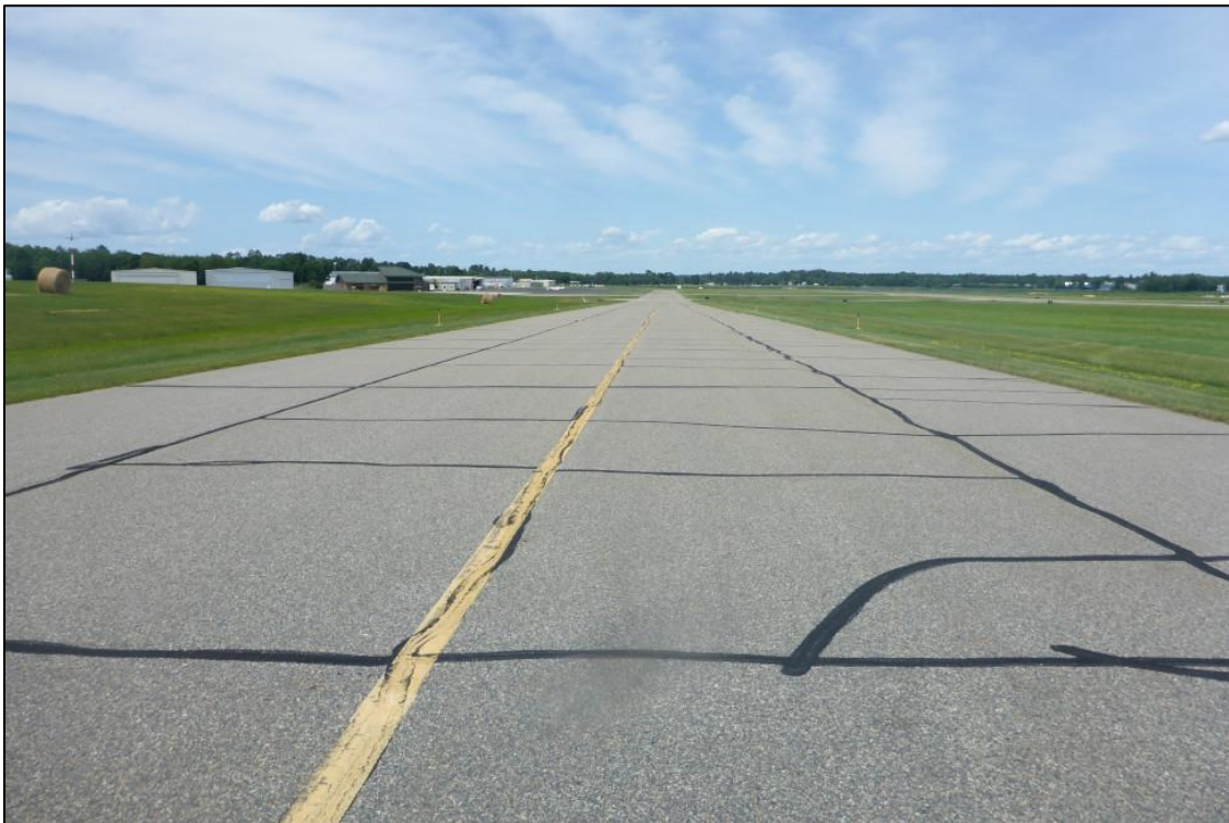
GPZ PTA 003 (PCI = 52)
