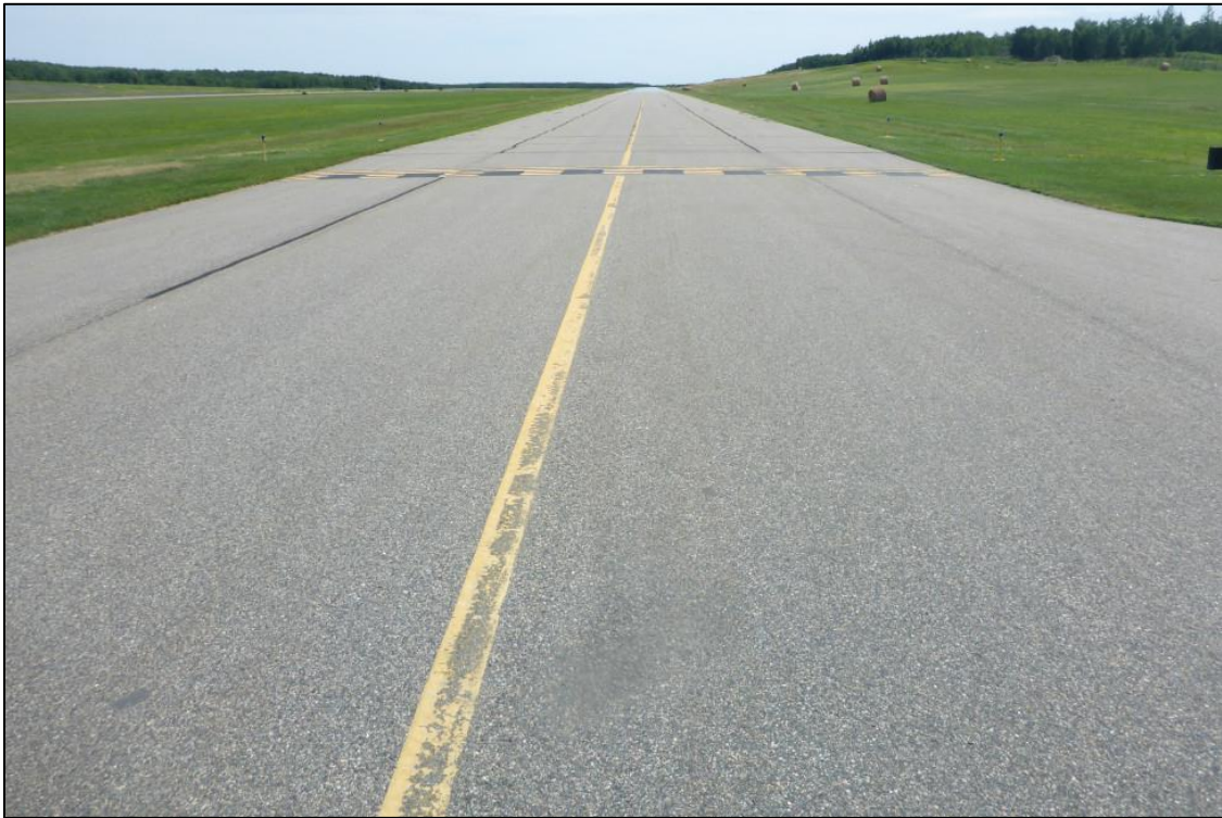
GPZ PTA 002 (PCI = 94)
