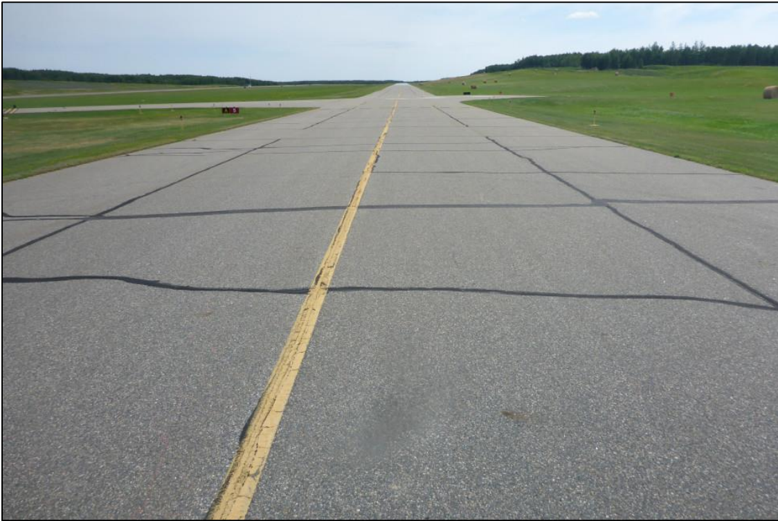
GPZ PTA 001 (PCI = 62)
