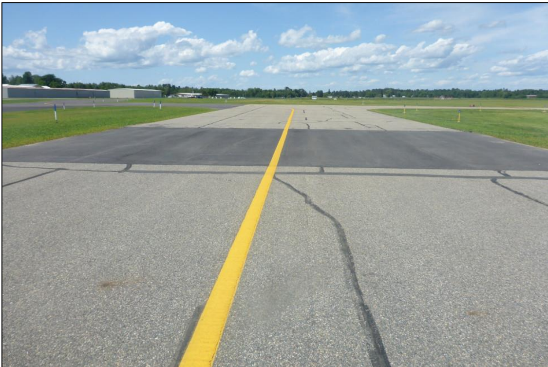
GPZ PTA 005 (PCI = 63)
