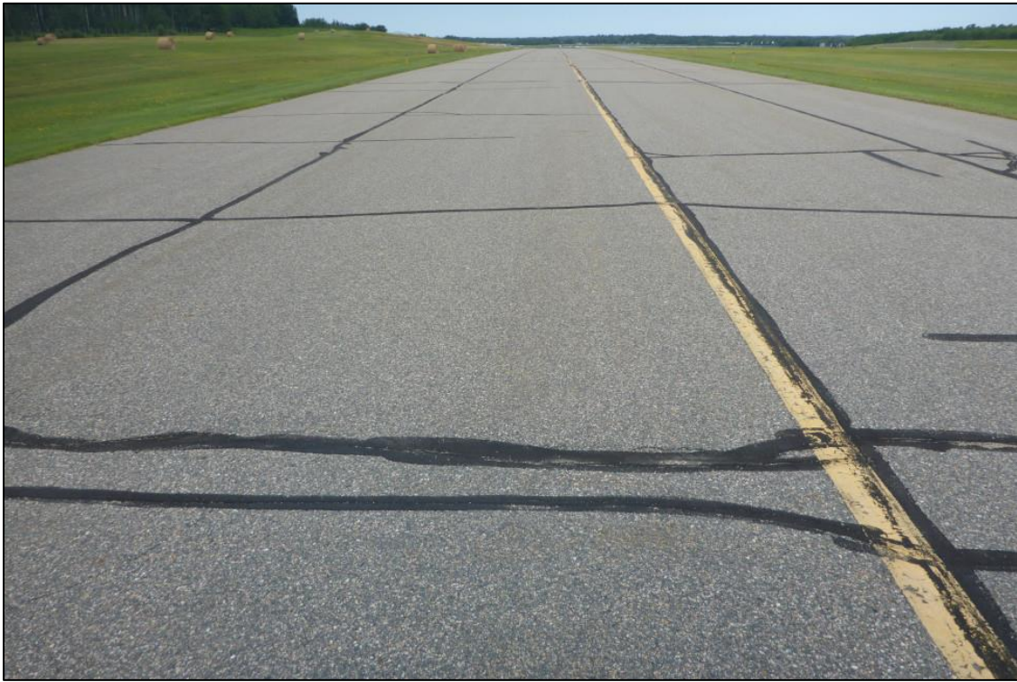
GPZ PTA 004 (PCI = 62)
