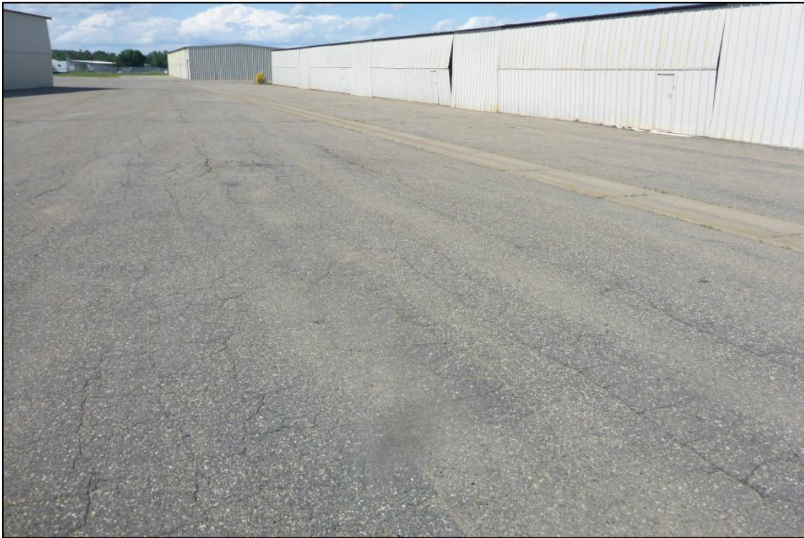
GPZ TLE 001 (PCI = 20)
